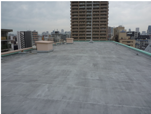
(工事前) 劣化が目立った屋上
