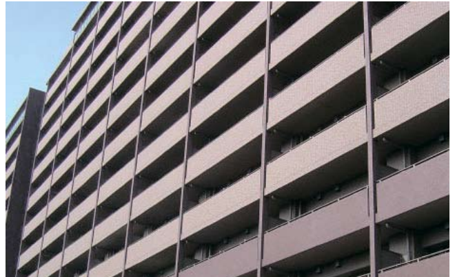
外壁タイルの浮きは目視では分かりにくいから厄介
